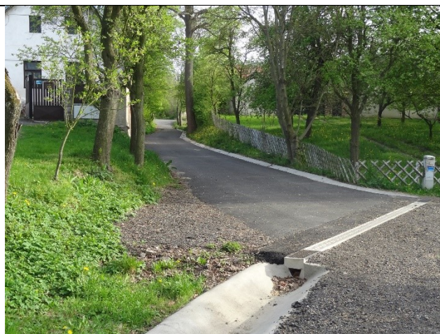
Realizované opatření na odvádění srážkových vod, KB ID 10407470_02
